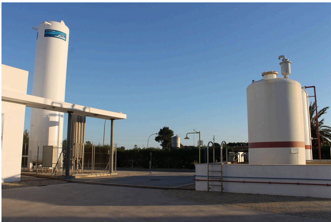
Desaladora de Santa Eulària (Eivissa) Europa Press
